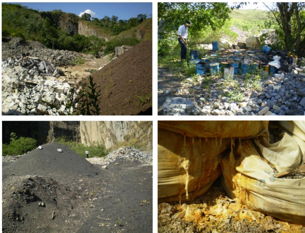
Figura 4: Irregularidades ambientais encontradas na pedreira abandonada em 2007 (Fotos do relatório de Carlos Lima Castro para o MPF).
